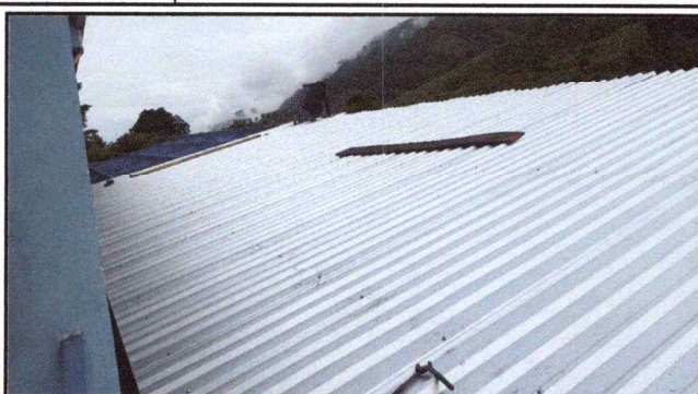
Foto 2: Sustrucción de láminas por deterioro por el paso del tiempo, imagen parcial de donde se localiza el salón de usos múltiples.
