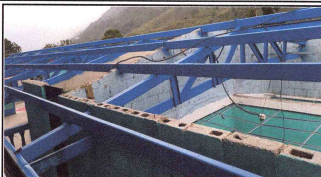
Foto 1: Sustrucción de lámina por deterioro, imagen parcial de donde se localizan aulas, dirección y parte del salón de usos múltiples.
